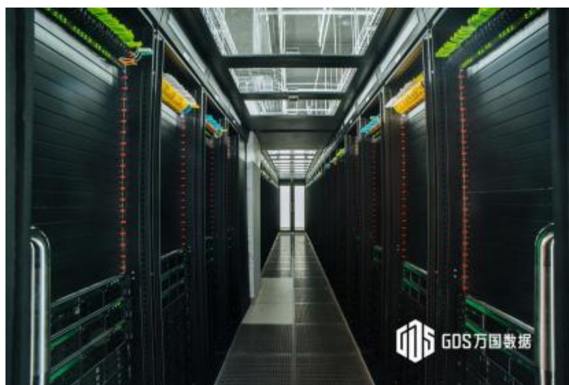
图 2-12 数据中心内部机柜空间实拍图
