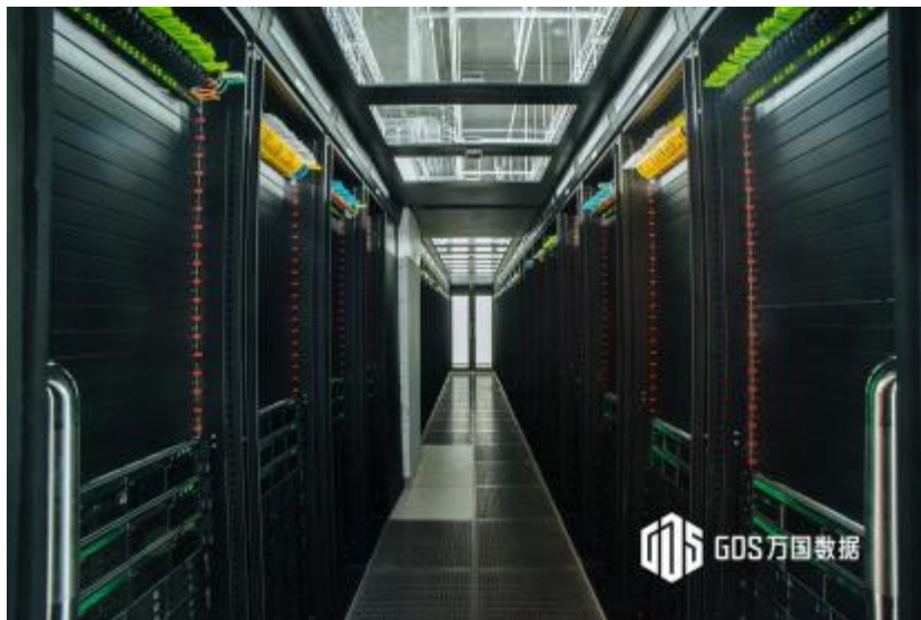
图 2-12 数据中心内部机柜空间实拍图
